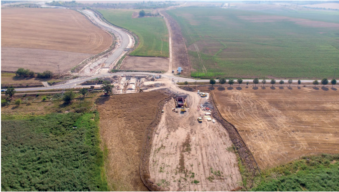
Versickerbecken an der L 173 und L 159n
